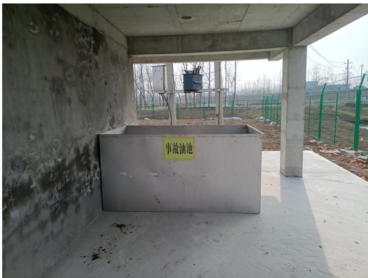
图 4-4 崔 6-8 风电场事故油池
