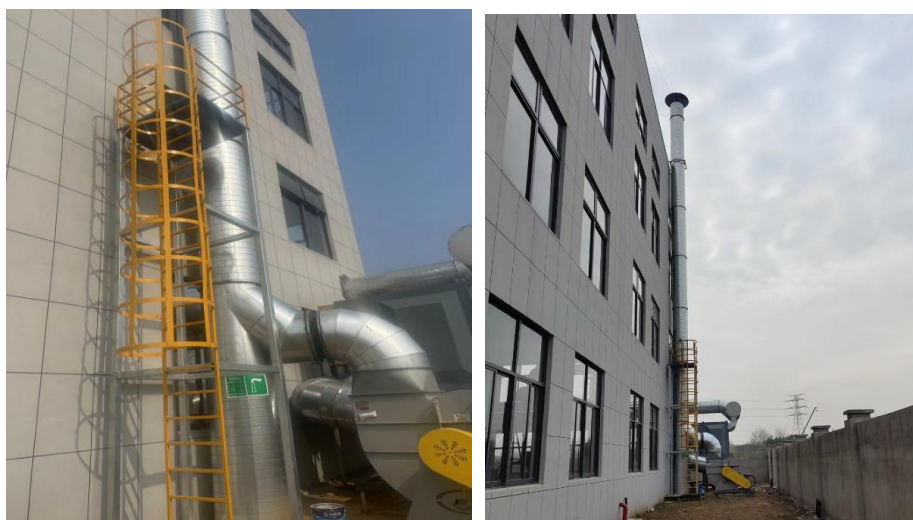
布袋除尘器+22米高排气筒 DA003 (2号车间)
