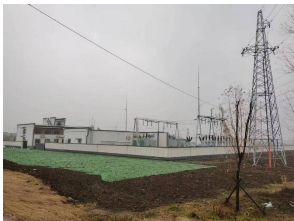
升压站外视图
