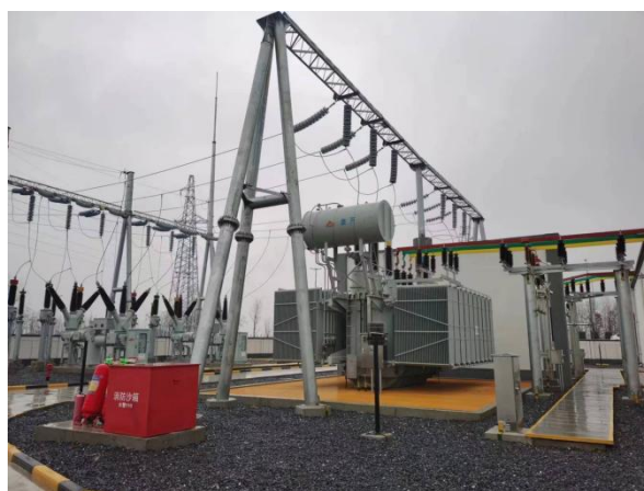
升压站内视图
