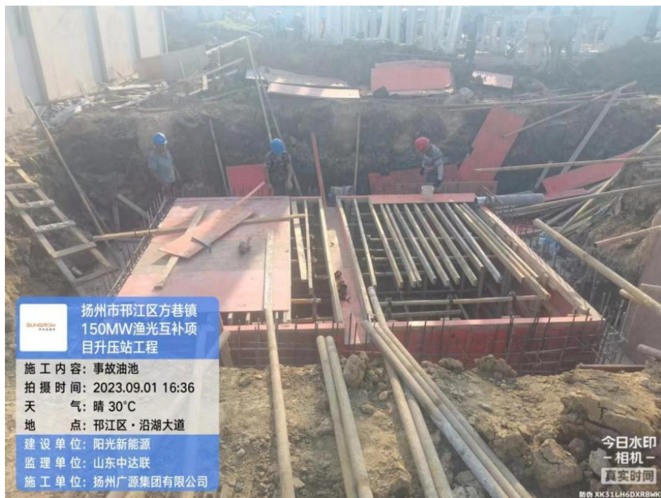
图 4-7 升压站事故油池
