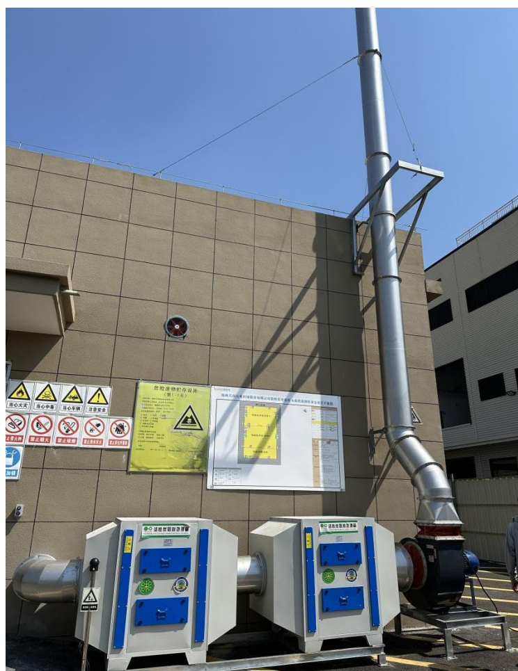
二级活性炭+15 米高排气筒 DA004（危废库）
