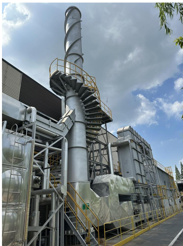
2 号 RTO 炉+18 米高排气筒 DA002（1 号车间）
