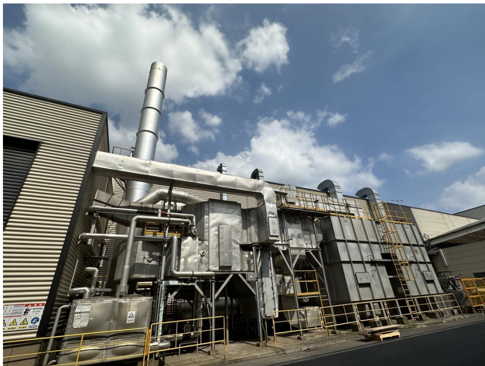
1 号 RTO 炉+20 米高排气筒 DA001（2 号车间）
