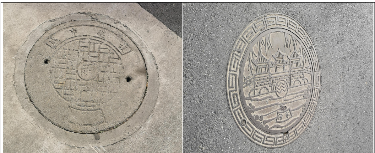
图 3-4 本项目雨污水外排口
