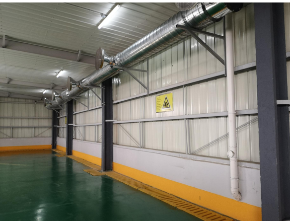
危废库废气收集装置
