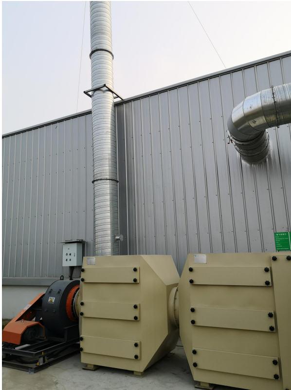
9#排气筒处理装置
