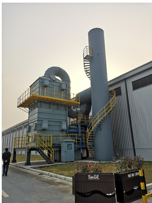
3#排气筒及处理设施
