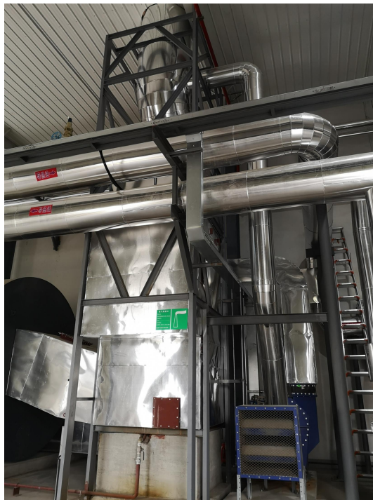
7#排气筒处理设施
