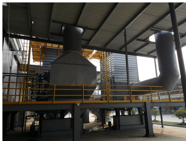
2#排气筒处理设施
