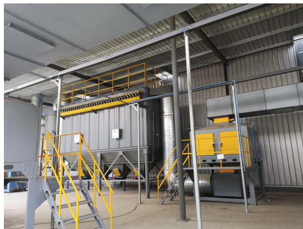
5#排气筒处理设施
