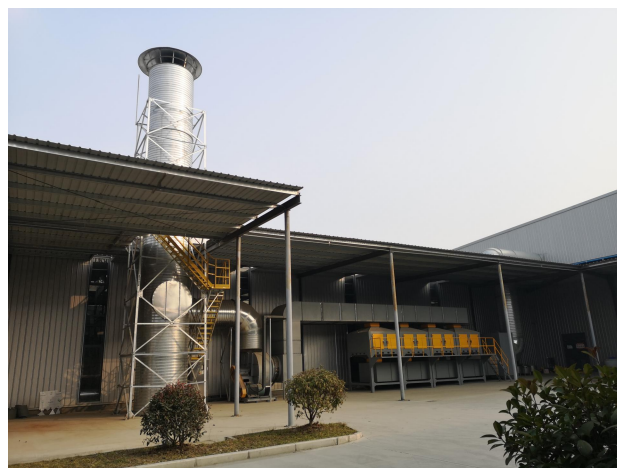
4#排气筒及处理设施
