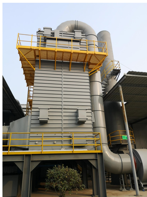
2#排气筒及处理设施
