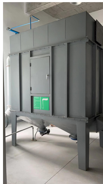
1#排气筒处理设施
