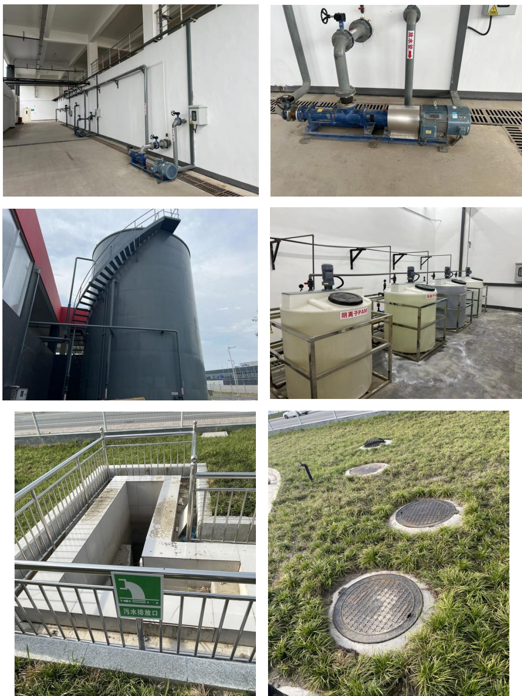
图 3-2 厂区内污水处理系统
