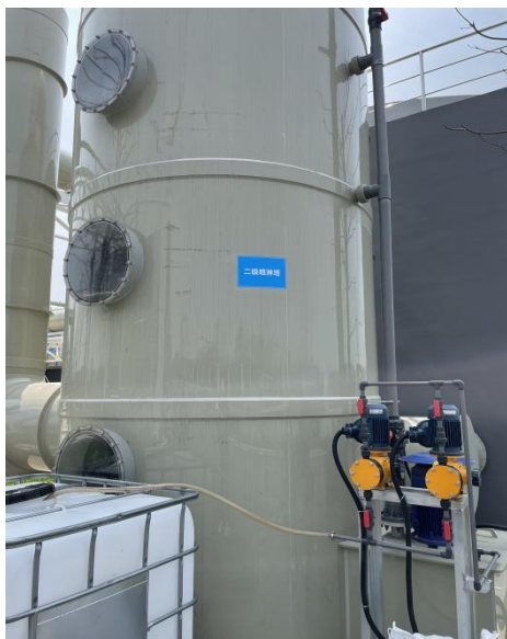
二级填料吸收塔
