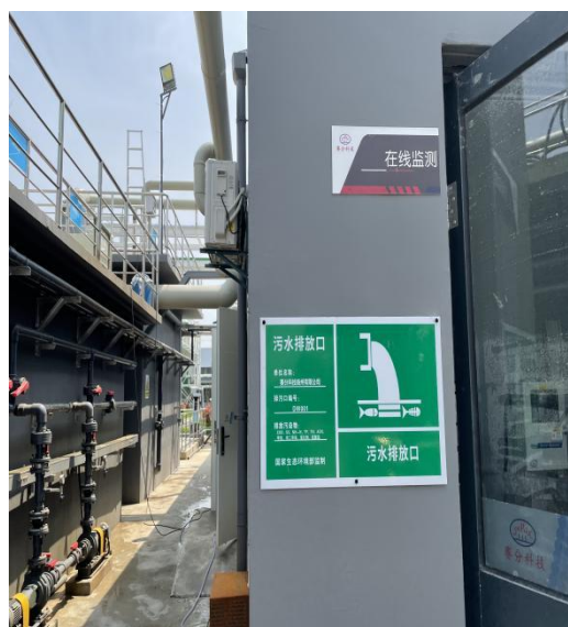
图 4.1-3 厂区污水排放口
