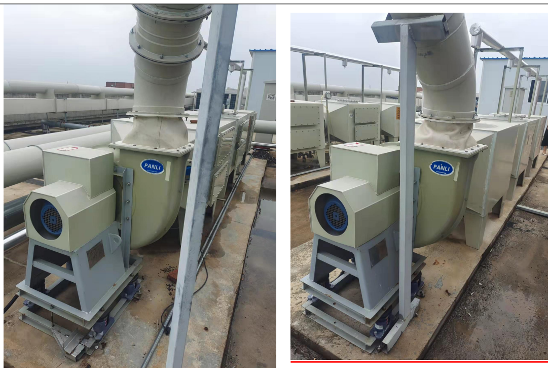
图 3-2 废气处理装置及环保标识牌
