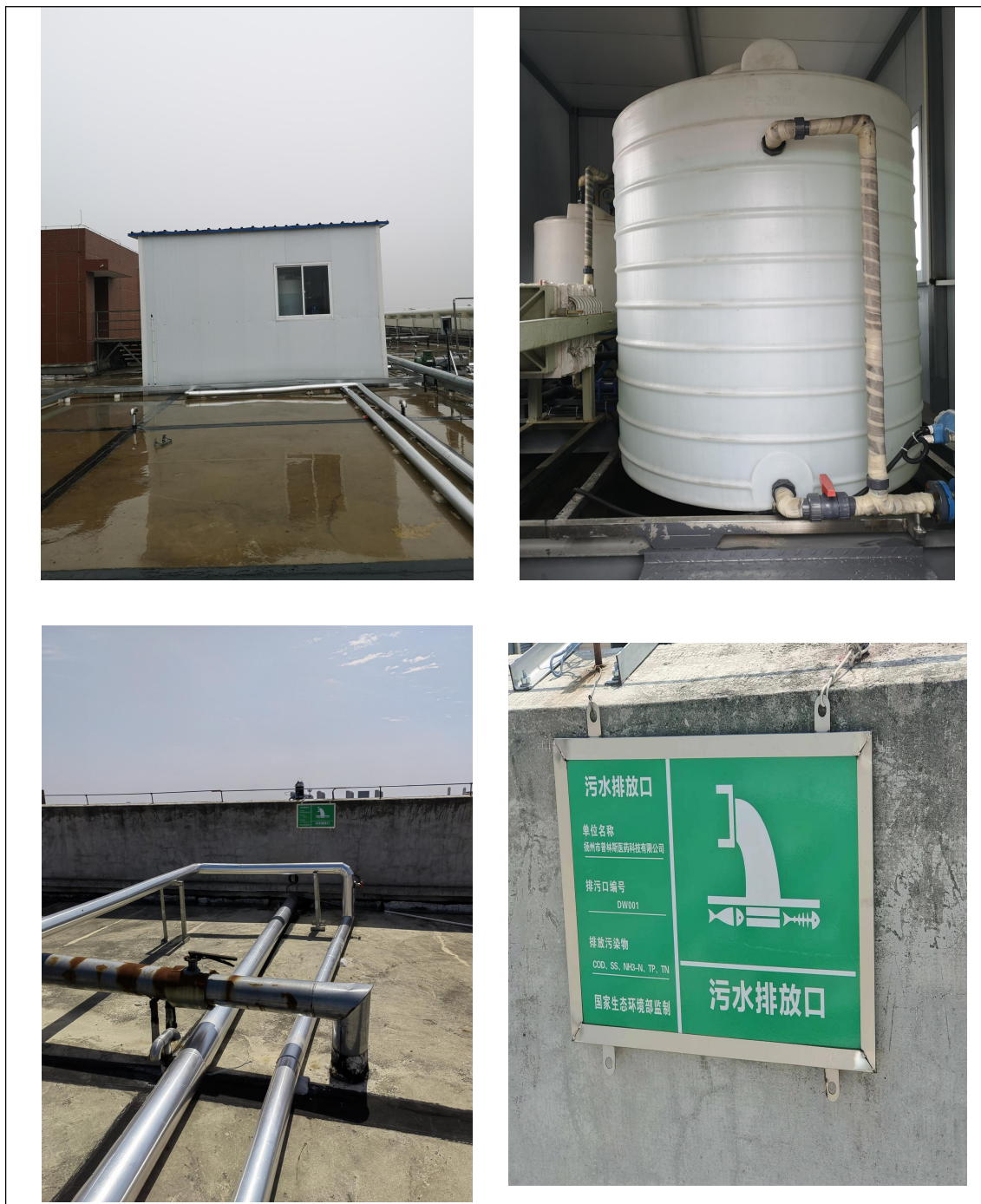
图 3-4 废水处理装置及环保标识牌
