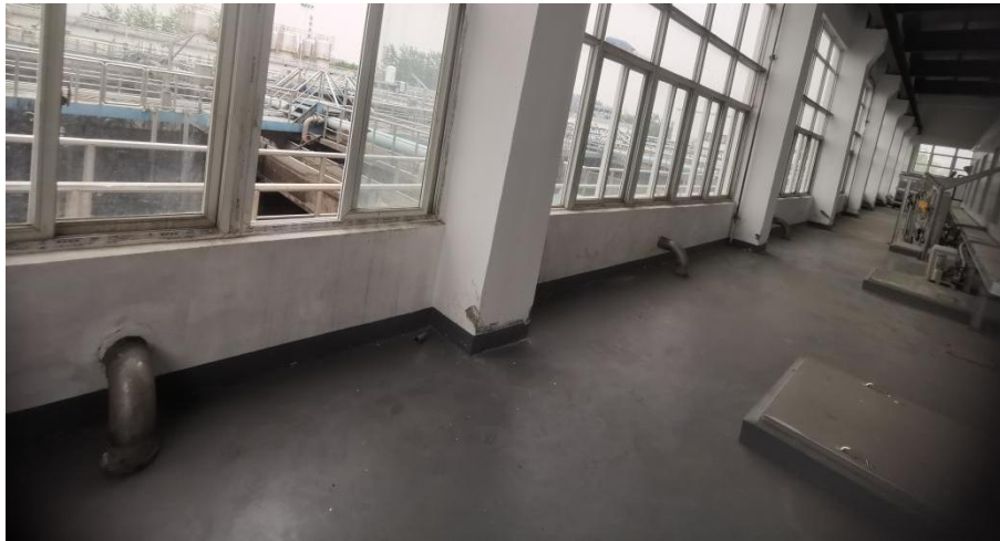
收集混合池负压收集
