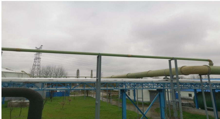
絮凝沉淀池（原初沉池）废气收集
