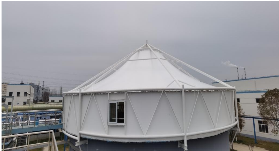
絮凝沉淀池（原初沉池）加盖装置
