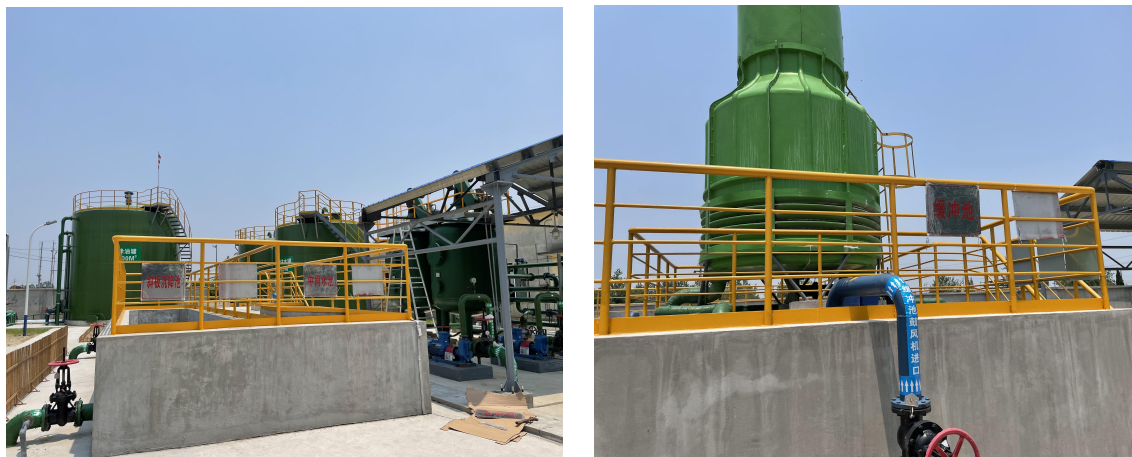
图 2.1-4 永 7-8 站污水处理
