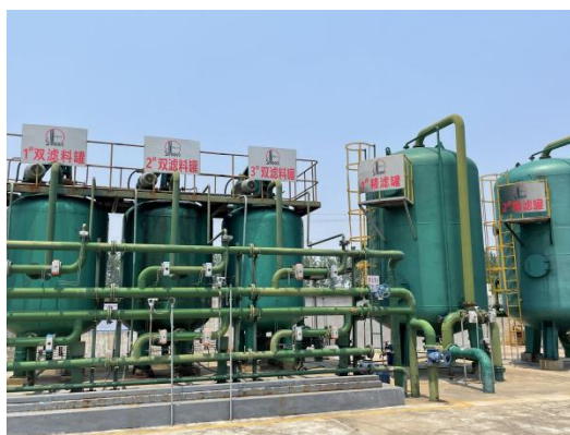
沙埕联合站滤罐
