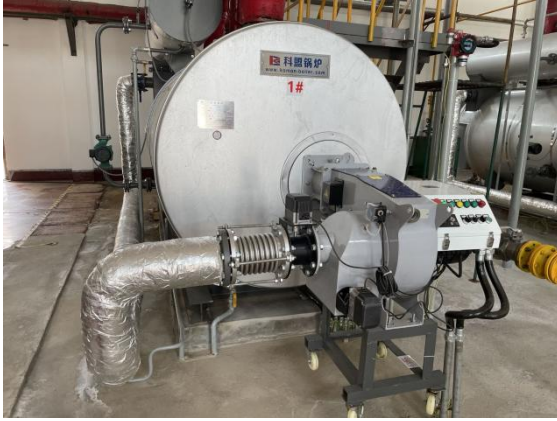
沙埝联合站锅炉
