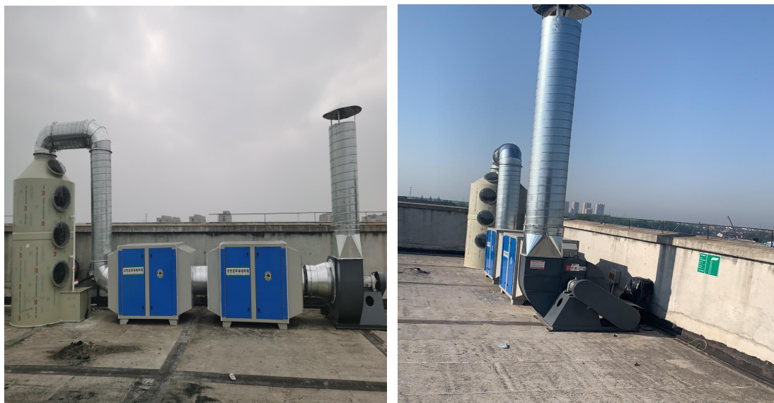
图3-5 废气处理装置及排气筒
