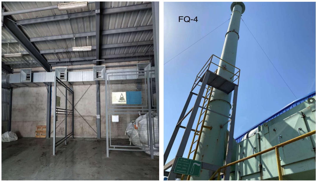
图3-6危废库废气处理设备及排气筒
