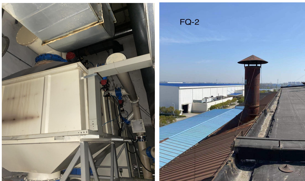
图3-5 FQ2排气筒及废气处理装置
