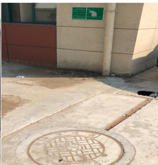
图 3-3 厂区污水排放口
