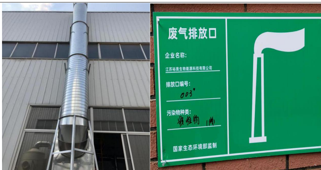
图 3-6 脉冲除尘+加压成型设备及排气筒标识标牌
