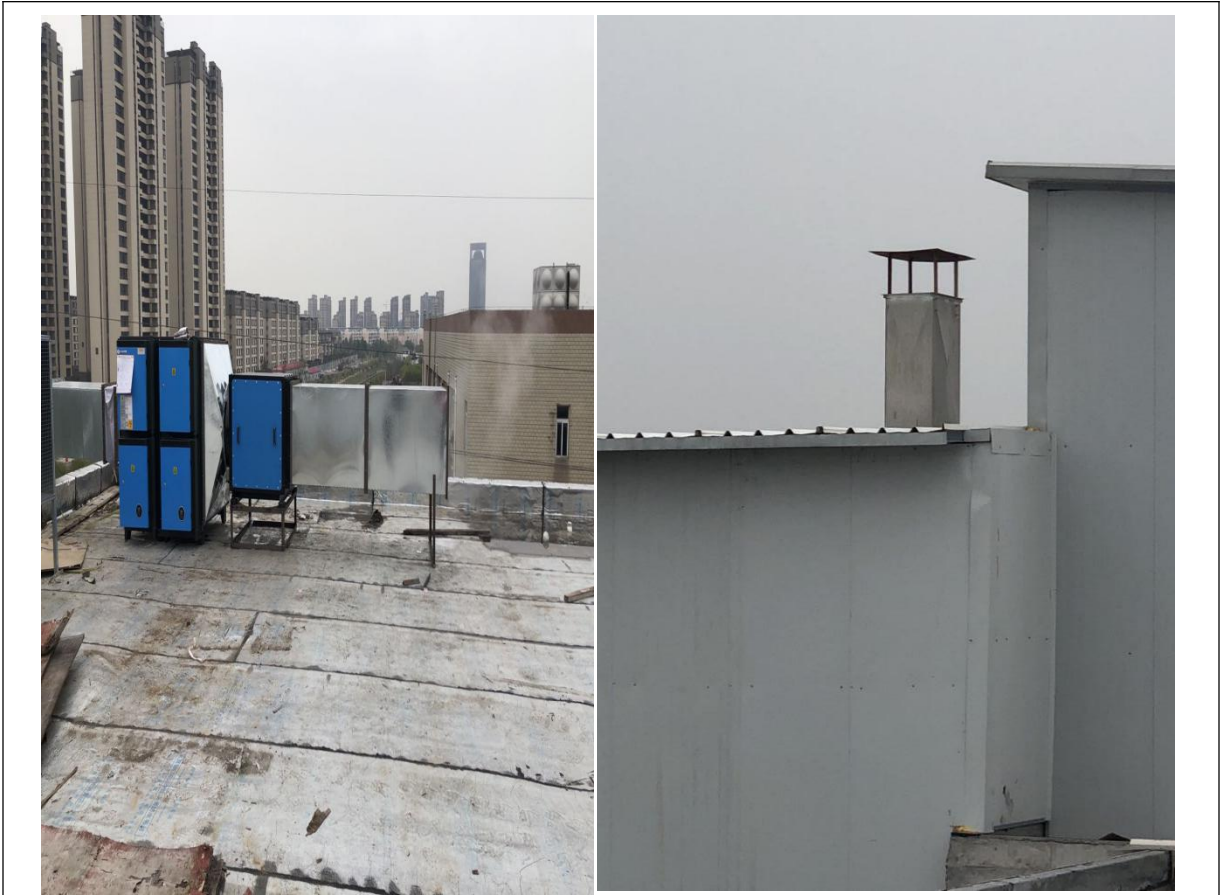
图 3-3 废气处理设施及排气筒图
