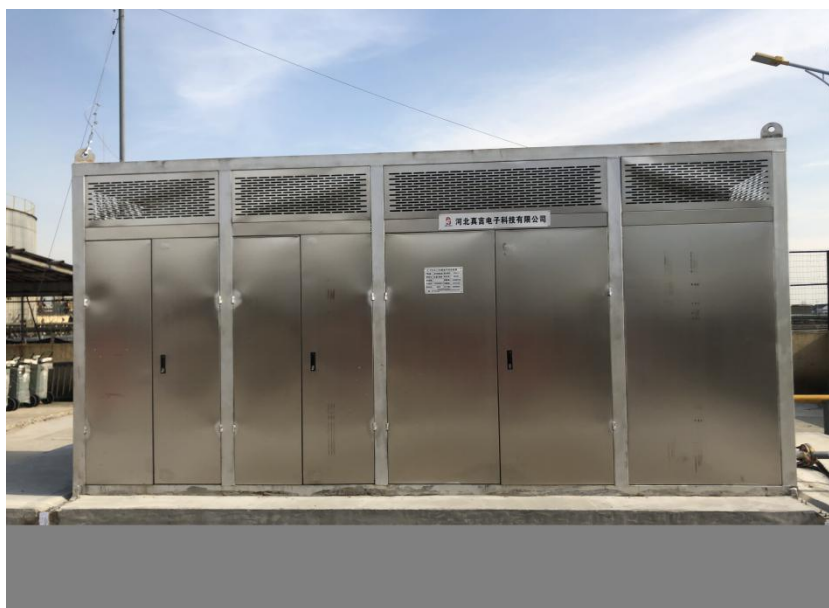
3-1 码头油气回收处理装置
