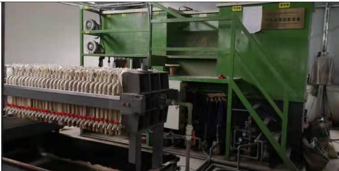
图 3-4 污水处理设备
