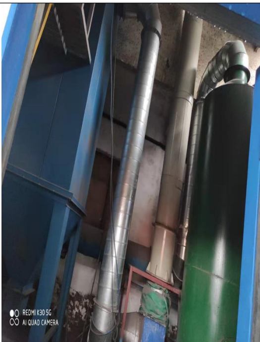
图 3-6 袋式除尘器及排气筒
