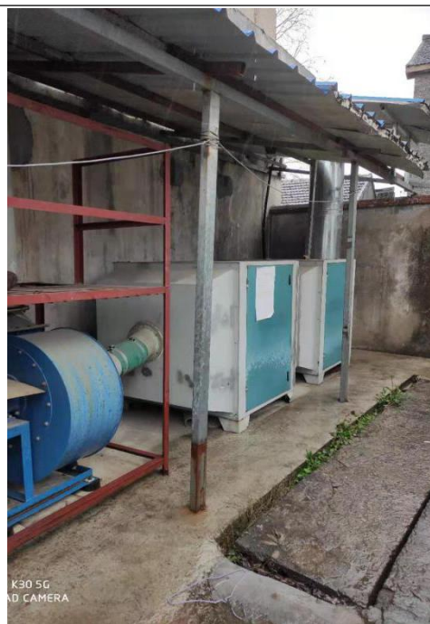
图 3-7 二级活性炭吸附装置及排气筒
