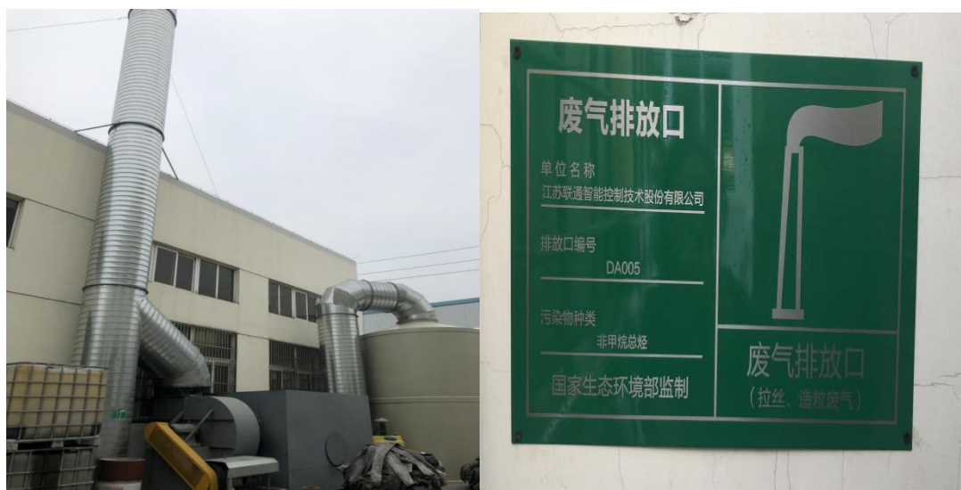
图 3-6 拉丝、造粒废气处置装置及排气筒标识标牌
