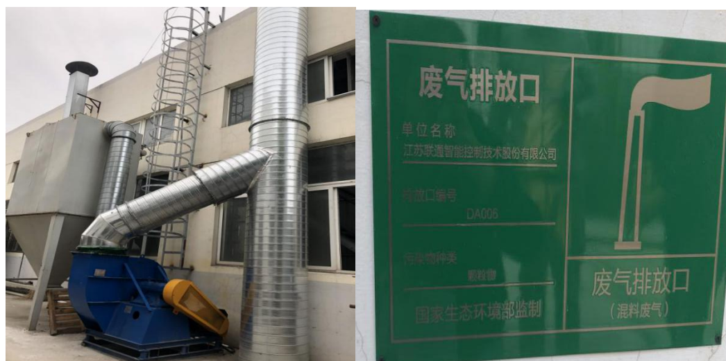
图 3-7 混料废气处置装置及排气筒标识标牌
