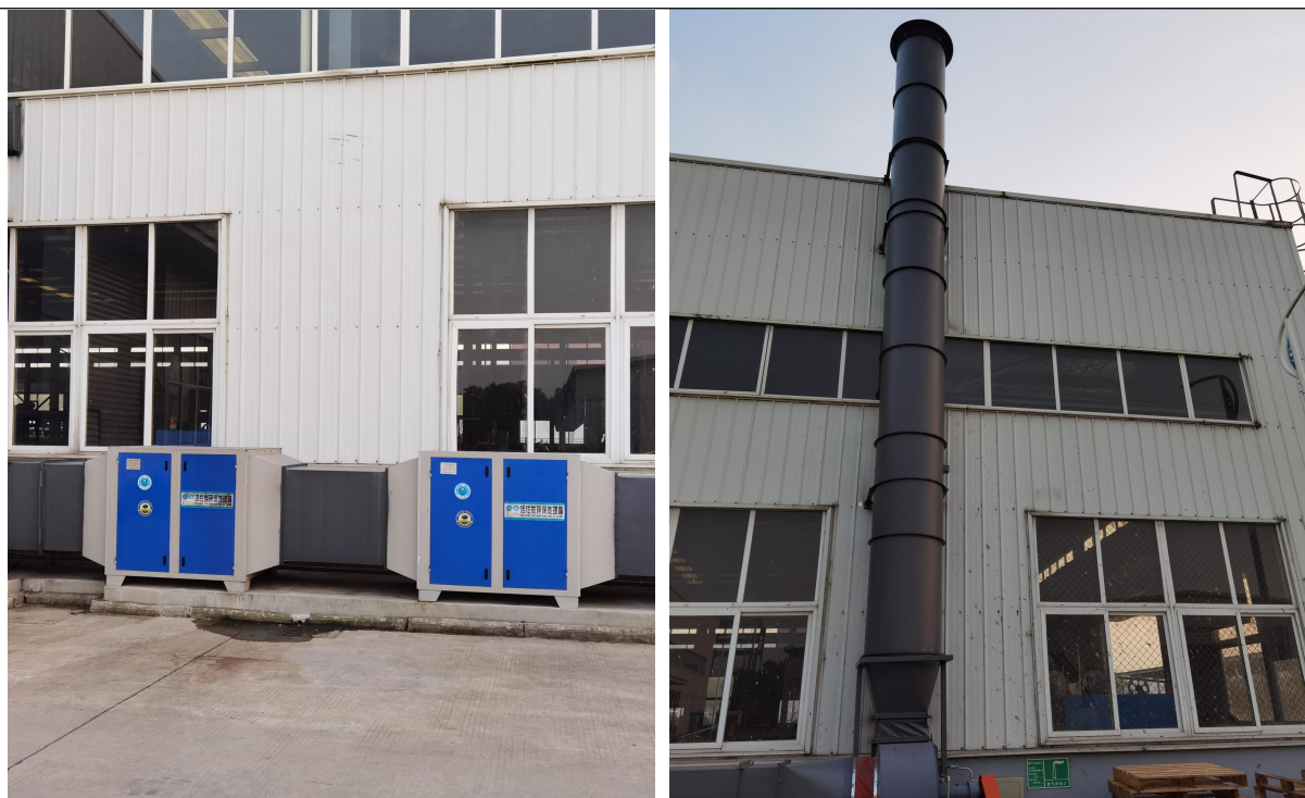
图 3-4 有机废气处理装置及排气筒
