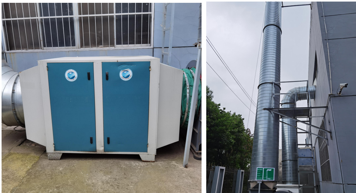
图 3-3 废气处理装置及排气筒
