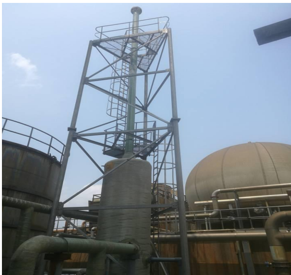
图 3-4 碱喷淋装置及排气筒（1#）
