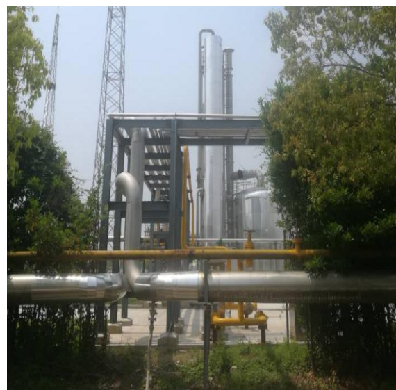
图 3-5 水喷淋装置及排气筒（2#）
