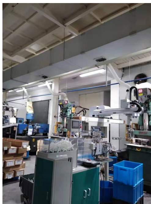
图 3-4 (b) 注胶机废气收集装置
