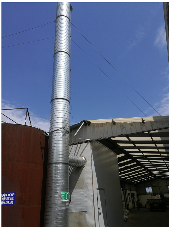
图 3-4 颗粒物及有机废气排气筒
