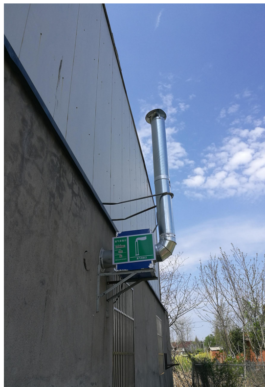
图 3-5 油烟净化器及排气筒
