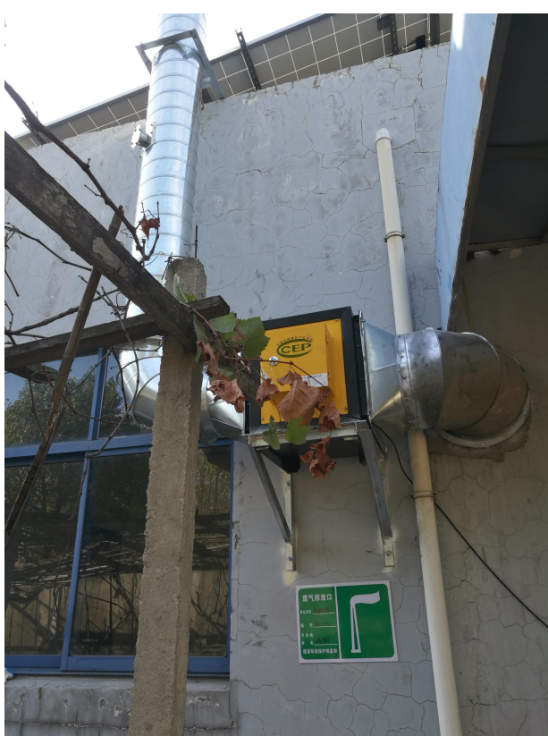
食堂废气排气筒及油烟净化装置
