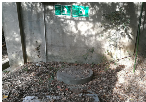
污水、雨水排口及标识牌
