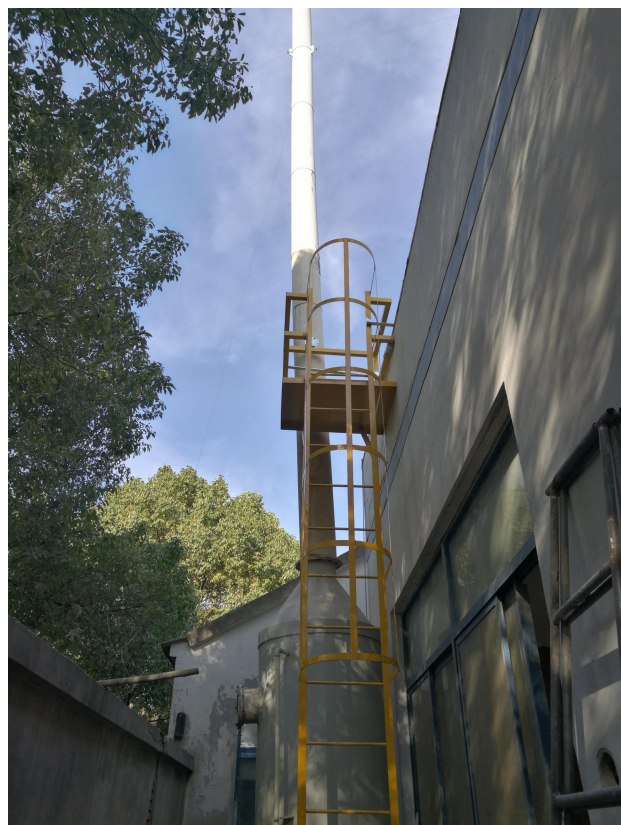
酸雾废气排气筒
