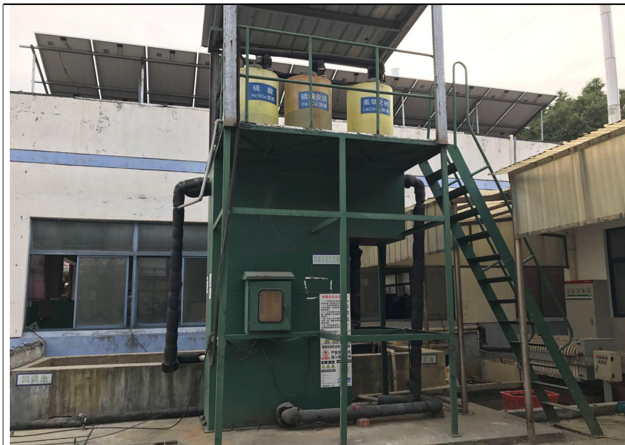
生产废水处理站
