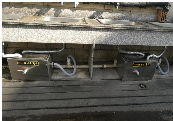
食堂废水处理装置
