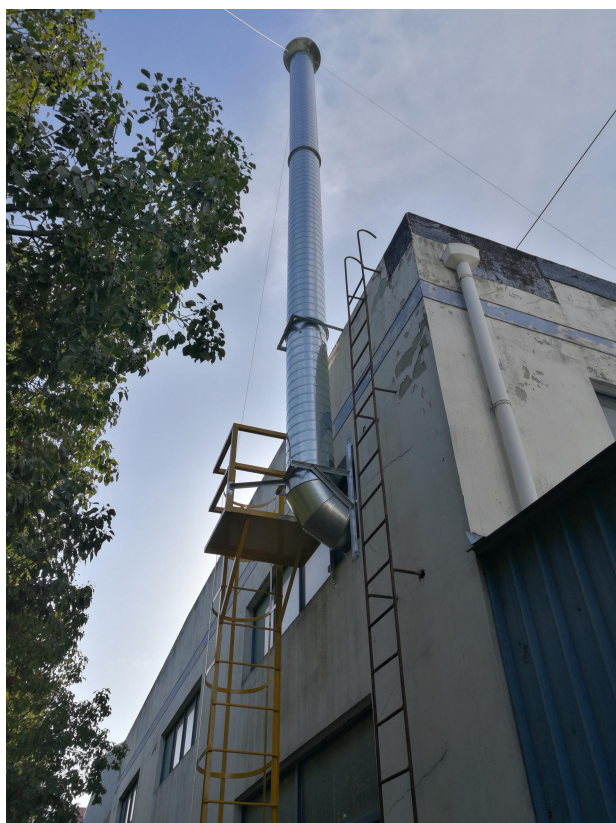
烘干、珩磨废气排气筒
