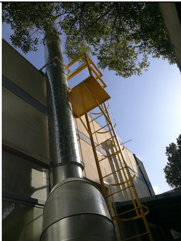
喷砂废气排气筒
