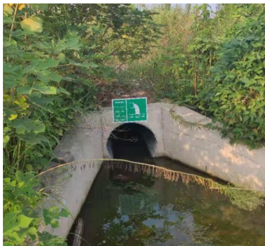
图 8 雨水排口 2 标识牌
