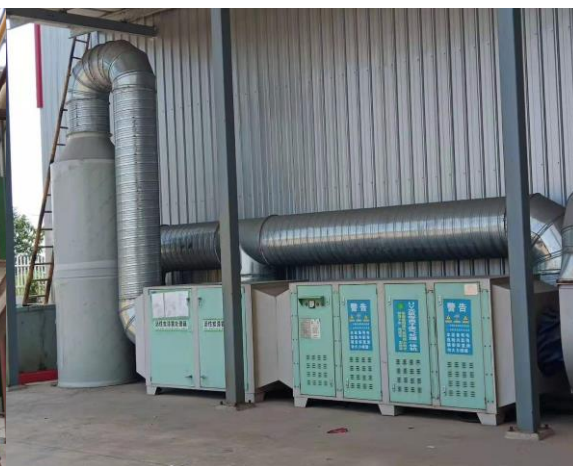
图 4 喷漆废气处理装置
