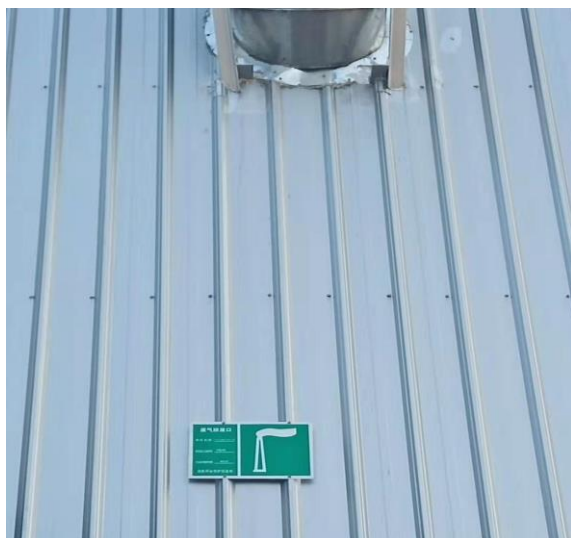
图 5 抛丸排口标识牌
