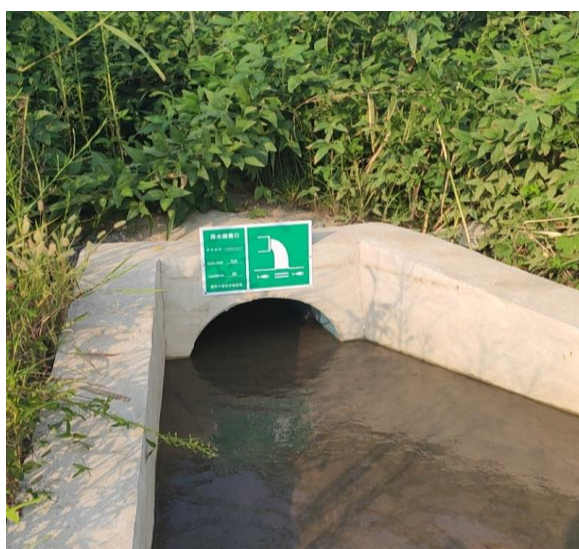
图 9 雨水排口 3 标识牌
