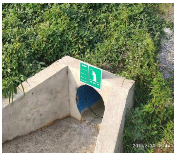
图 7 雨水排口 1 标识牌
