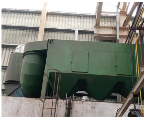
图 3 抛丸废气处理装置
